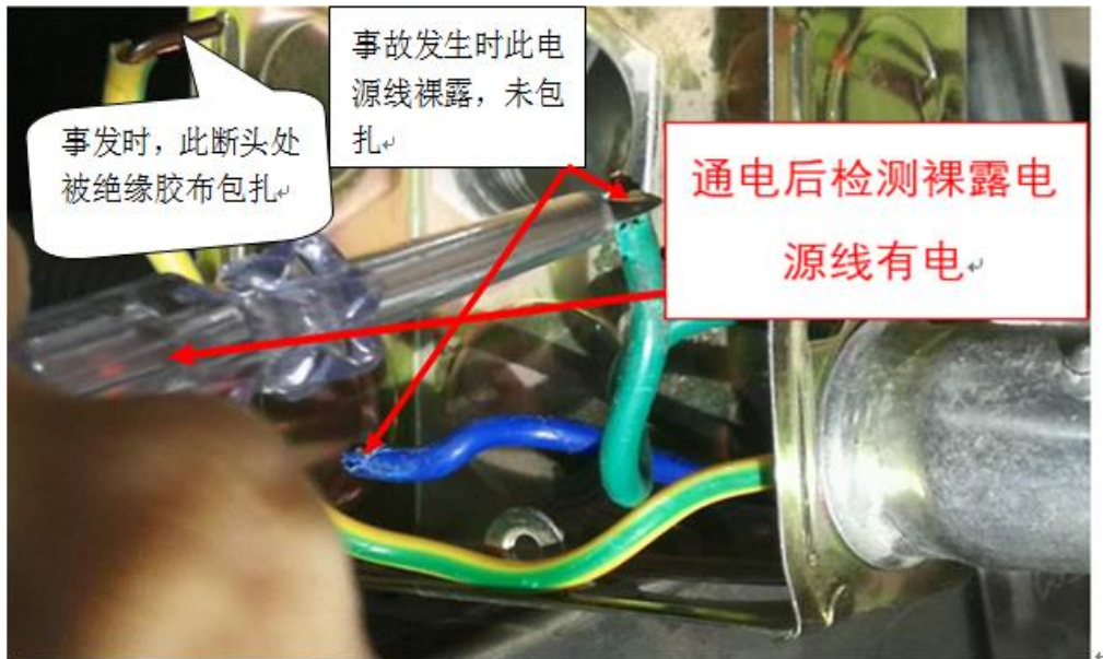
现场被剪电源线测电状况
